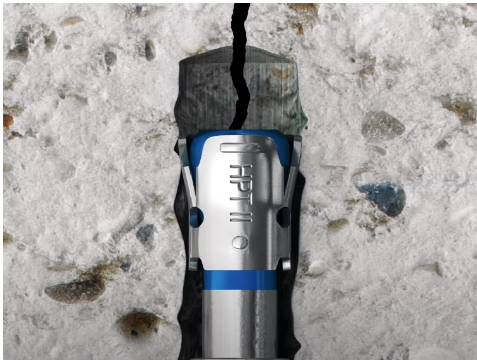
Hình 8: Đá bị nứt, vỡ trong quá trình xiết bulong nở
